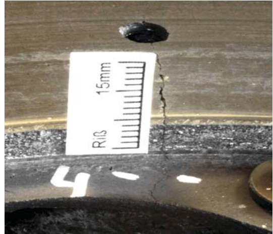
Grieta de propagación crítica en la zona de anclaje
