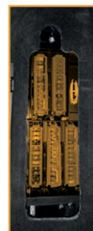
Блок реле и предохранителей SB за площадкой для левой ноги
