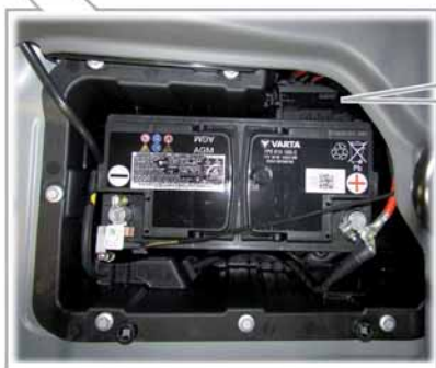
Batterie unterhalb Fahrerfußraum
