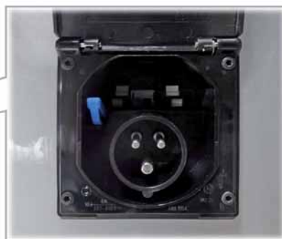
Am Seitenteil hinten 230-Volt-Einspeisung
