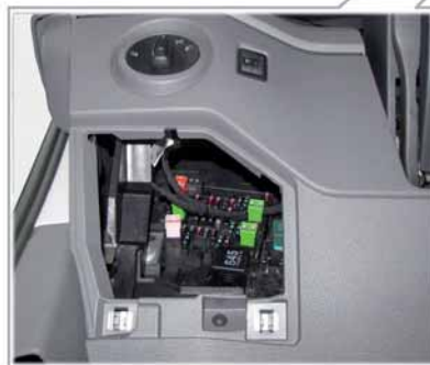
In der Instrumententafel Relaisträger und Sicherungshalter C (SC) mit Bordnetzsteuergerät J519
