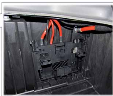
Hauptsicherungen (SA) der Batterie
