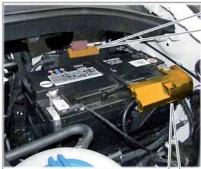
Sicherungen im Motorraum
